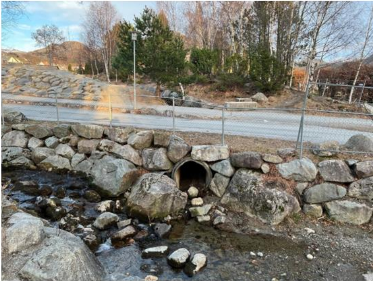
Bilde: Kommunal stikkrenne (Foto: Geir Magnus Tunland, Statens vegvesen)
